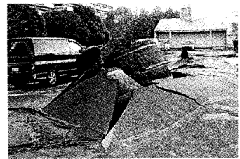
せり上がったマンホール (千葉県浦安市広報号外より)
